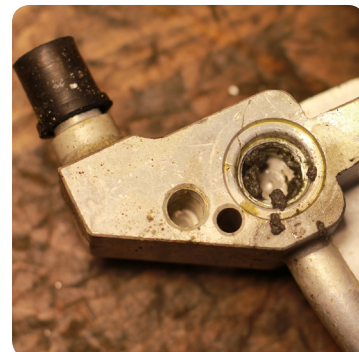
Synligt snavs ved kondensorindløbet
